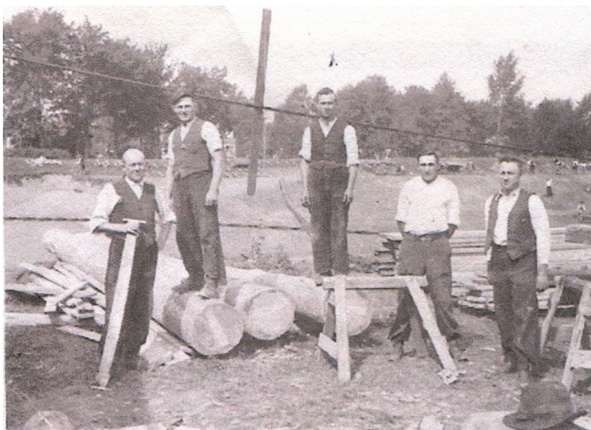
Cieśle przygotowują drewniane bale, które będą stanowić podporę tymczasową pod stalowy most w trakcie jego rozbudowy. Prawdopodobnie owi robotnicy wykonywali także szalunki pod żelbetowe podpory.
