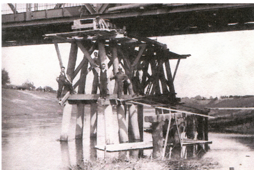
Zdjęcie przedstawia tymczasową podporę stalowego fragmentu mostu. Stoi ona wzdłuż biegu koryta rzeki, zabezpieczając most podczas dobudowy części żelbetowej. Użyte do tego celu bale z drewna miały średnicę około 50 cm.
